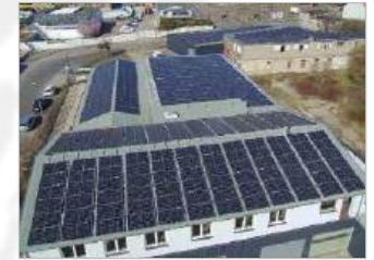
Deutschland Dachfläche in Betrieb 1.06 MWp
