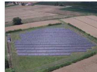
Italien Freifläche in Betrieb 500 kWp
