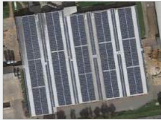
Deutschland Dachanlage in Betrieb 929 kWp
